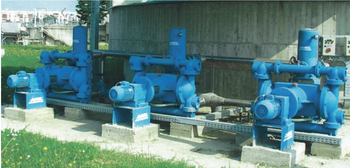
ABEL EM en una depuradora municipal: la alternativa más económica para transportar lodos con contenido fibroso.
