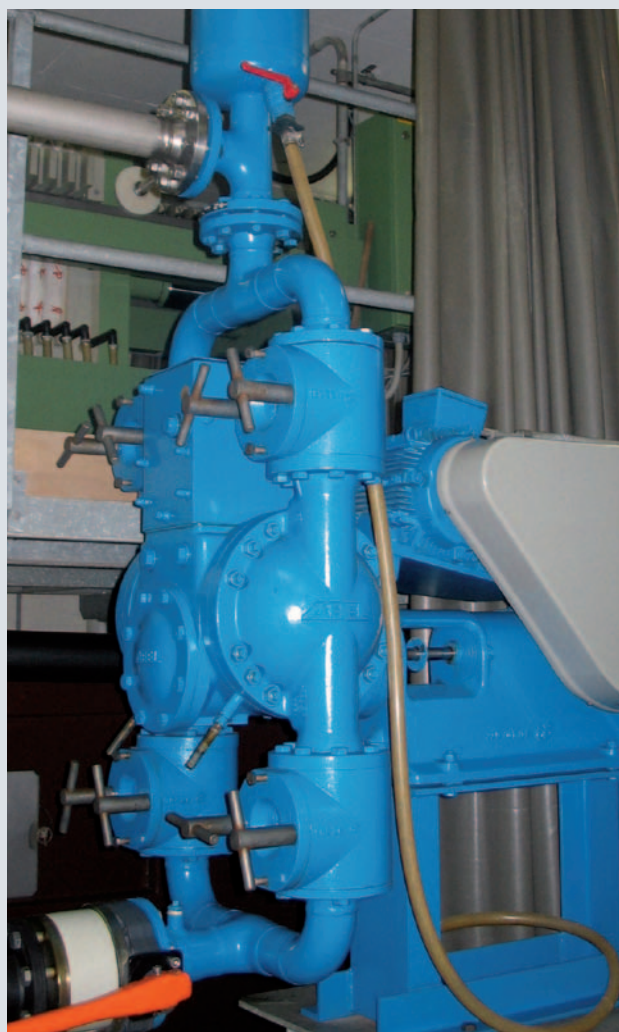
Válvulas de bola con apertura de inspección y detector de fugas en la membrana
