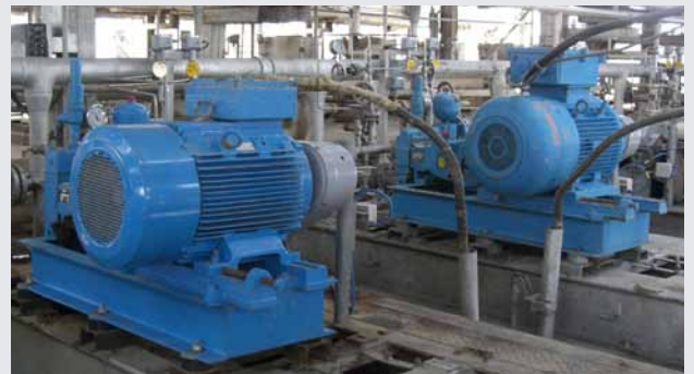
ABEL Hochdruckpumpe zur Injektion von Ethylenglykol bei der Gaswäsche
