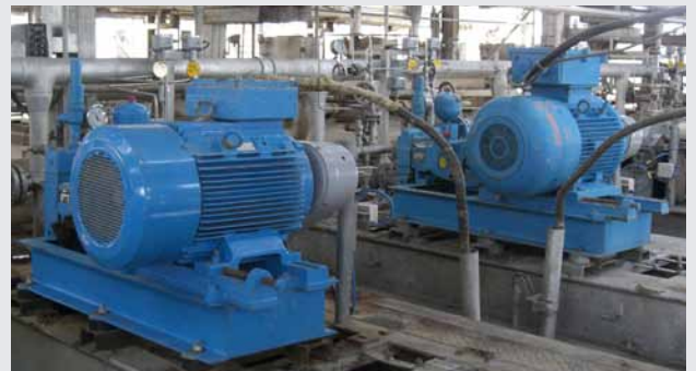
ABEL Hochdruckpumpe zur Injektion von Ethylenglykol bei der Gaswäsche
