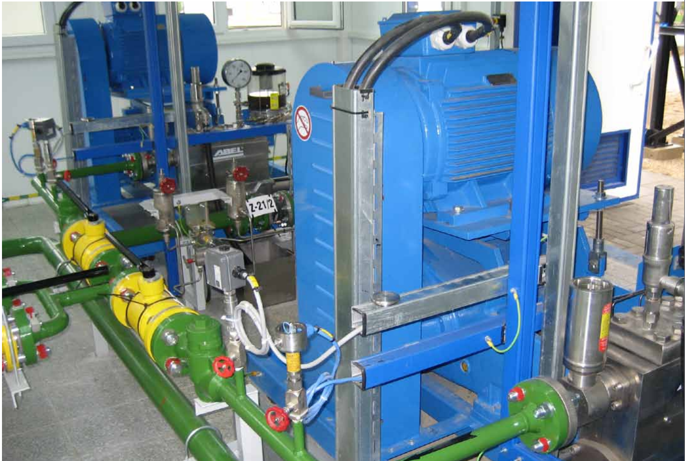
ABEL HPT zur Förderung von ölhaltigem Salzwasser bei der Gasgewinnung
