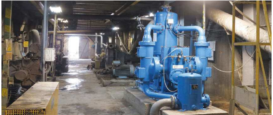
Hydraulische Membranpumpe Typ Abel HMD-G-50-0500 zur Befüllung der Kammerfilterpresse im Bergwerk.
