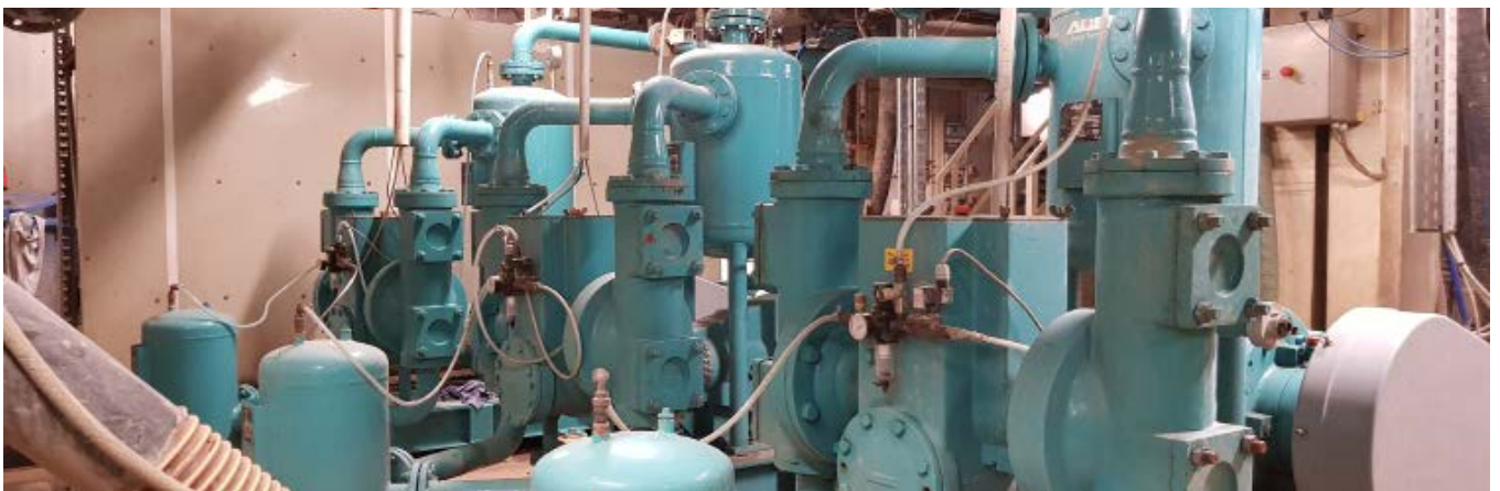
Hydraulische Membranpumpen vom Typ HMD-G-32-0250 bei der GBAV
